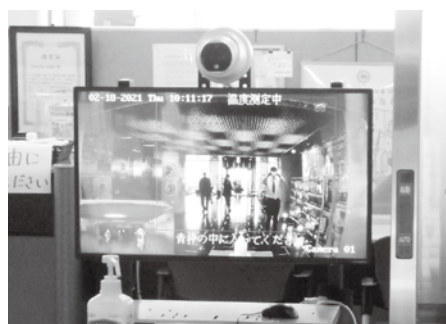
当所入口に設置しているサーマルカメラ
